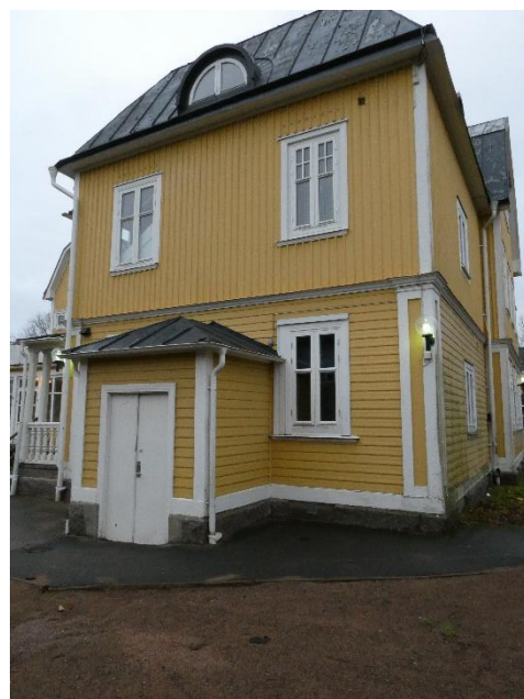
Källaringång med ursprunglig pardörr bakom skivmaterial.
